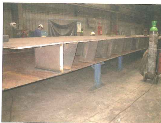
- Le soudage et l'habillage des poutres en semi-automatique au fil fourré sous gaz (MAG) :
